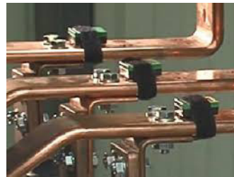
Рис. 1.8. Комплект датчиков Easergy TH110, установленных на 3 фазах электрического соединения
